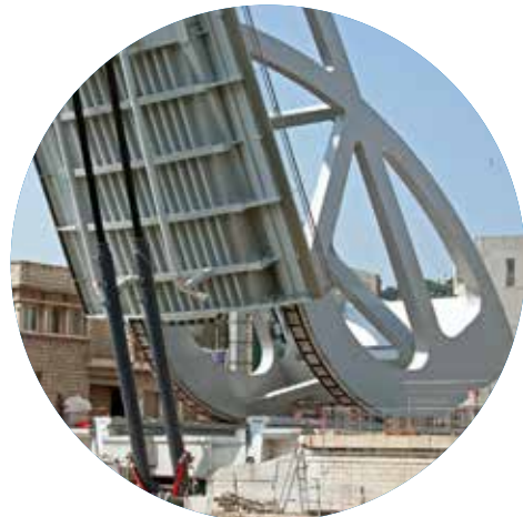
Pont basculant Sadi Carnot – Sète Rénovation des structures et des mécanismes de manœuvre.
