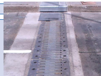
Joint de chaussée souffle 240mm
