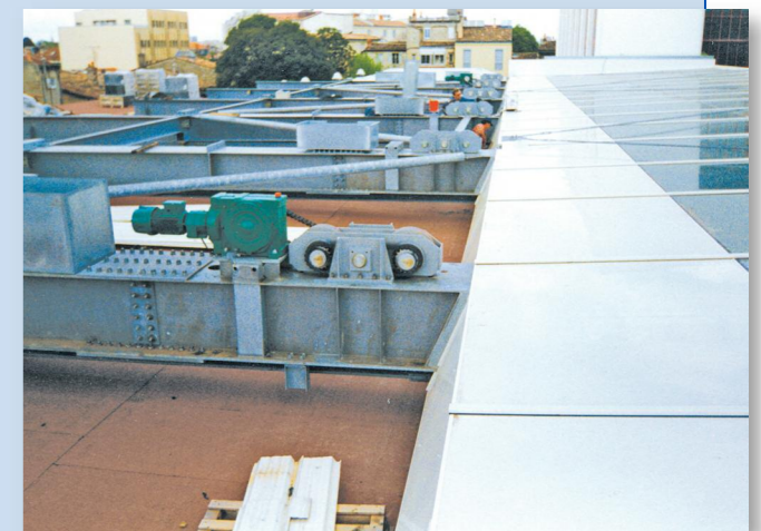
Motorisation de la toiture
