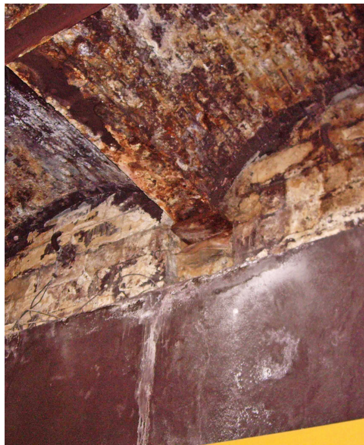
Appuis endommagés avant travaux
