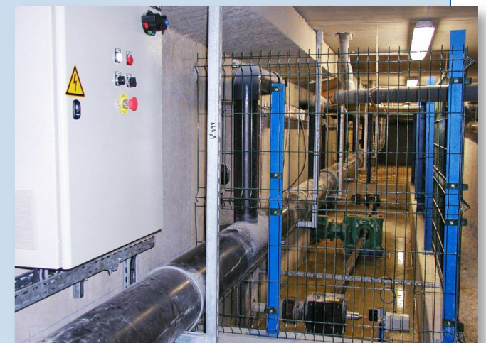
Motorisation en sous-sol dans la galerie technique
