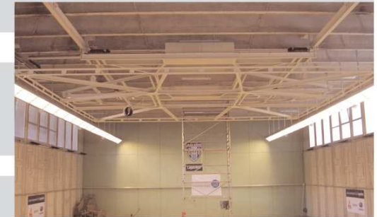
structure repliée sous la toiture du bâtiment
