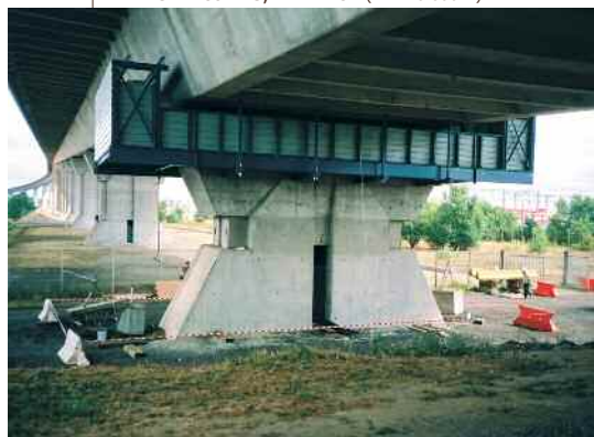
4- PONT DE CHEVIRÉ - NANTES (44) : CHANGEMENT DES APPAREILS D'APPUIS SUR PILES ET CULÉES, VÉRINAGE (11 X 6 000 T)
