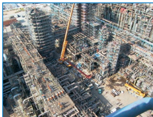
Site pétrochimique de SHELL à Berre l'Étang (13) - 'REBOUND BACK END PROJECT' - vue de 53 m.
