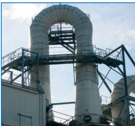
Réseau de refroidissement de la chaudière du centre de traitement de déchets de Courrières (62) pour SOTRÉNOR
