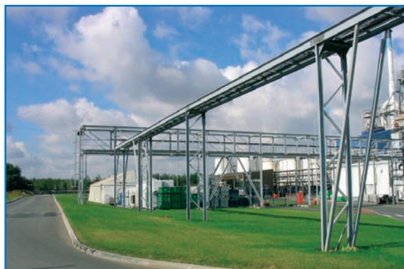
Racks de distribution des fluides dédié au traitement des déchets industriels pour SOTRÉNOR
